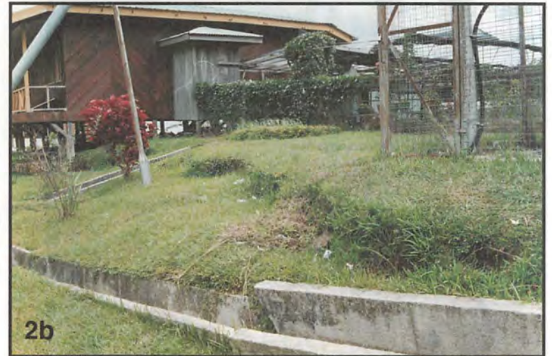
Rajah 2. Fotograf menunjukkan a) kedudukan SMK Kundasang dilihat dari selatan; b) tebing gelinciran K5a yang telah merosakkan jalan, dinding penahan dan bahagian dasar surau.
