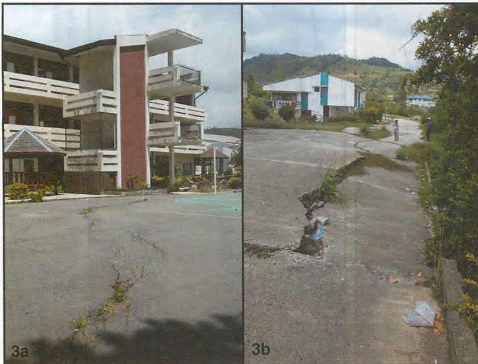
Rajah 3. Fotograf menunjukkan a) rekahan mewakili tebing gelinciran ulangan. Gelinciran yang sama pada tahun 1994 telah merosakkan sebuah bangunan sekolah yang terpaksa dirobohkan; b) tebing gelinciran K5c dengan jatuhan sekitar 1.5m telah merosakkan jalan menuju ke hostel guru.
