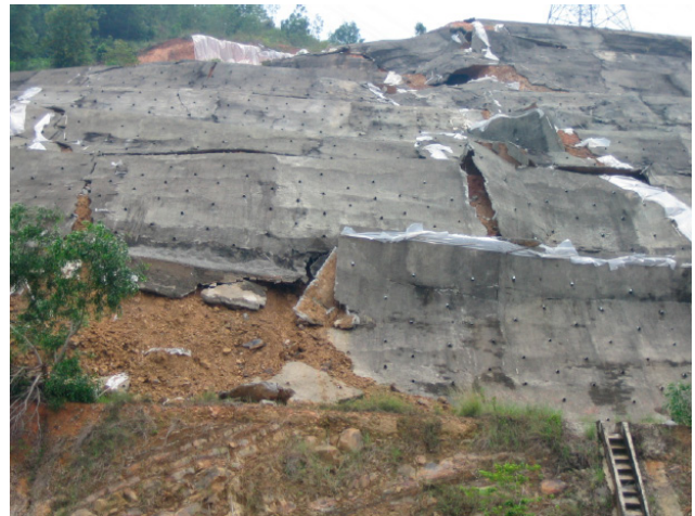
Rajah 5: Kerosakan teruk pada dinding permukaan cerun (Jalan Sepangar).
