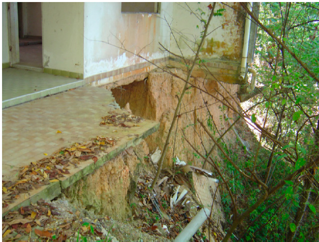
Rajah 4: Keretakan pada struktur asas bangunan (Taman Winley).
