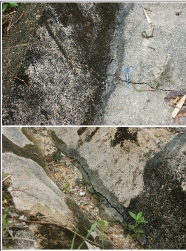
Rajah 12: Retakan tegangan yang terbentuk pada sistem saliran pada bahagian tengah cerun tambakan.
