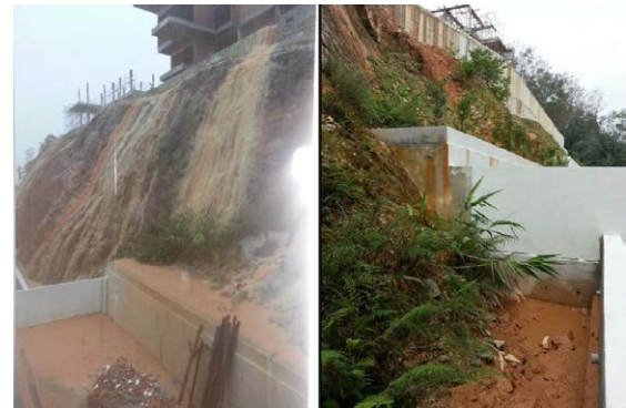
Rajah 7: Kejadian geobencana aliran lumpur dan puing akibat larian air permukaan yang tidak terkawal dari bahagian atas cerun. Puing yang dihakis dimendapkan pada bahagian kaki cerun di belakang unit perumahan. Ketidadaan sistem saliran yang sempurna untuk menguruskan larian air permukaan telah mencetuskan masalah ini. Gambar dirakamkan oleh pemilik unit perumahan.
