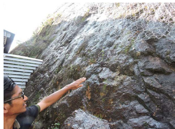
Rajah 8: Orientasi satah kekar yang miring kearah muka cerun, ditambah dengan permukaannya yang basah akibat pengaliran air bawah tanah boleh mencetuskan kegagalan cerun. Tiada sebarang sistem saliran dipasang pada jasad cerun untuk menguruskan air bawah tanah.
