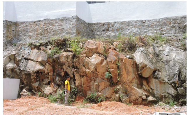
Rajah 4: Singkapan batuan granit di tapak pembinaan di bahagian atas cerun yang dikaji. Perhatikan kewujudan satah kekar dan sesar yang terbentuk dengan baik. Persilangan antara satah kekar dan sesar menghasilkan blok-blok batuan yang tidak stabil dan berpotensi untuk gagal dalam bentuk kegagalan baji.
